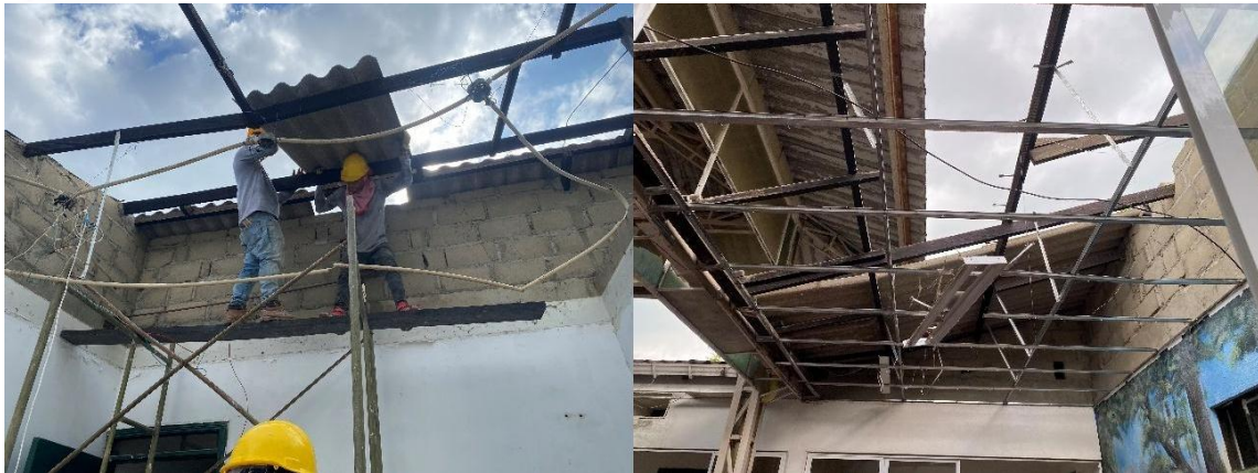
Imagen 3 Desmante de Cubierta en mal estado
